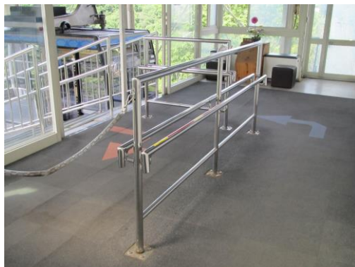
手すり（日本平駅ホーム付近）
