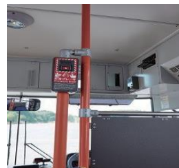
車内警告灯 (前)
